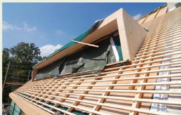
L'isolation de toiture, composée de ouate de cellulose et d'une sous-couverture en fibre de bois.
